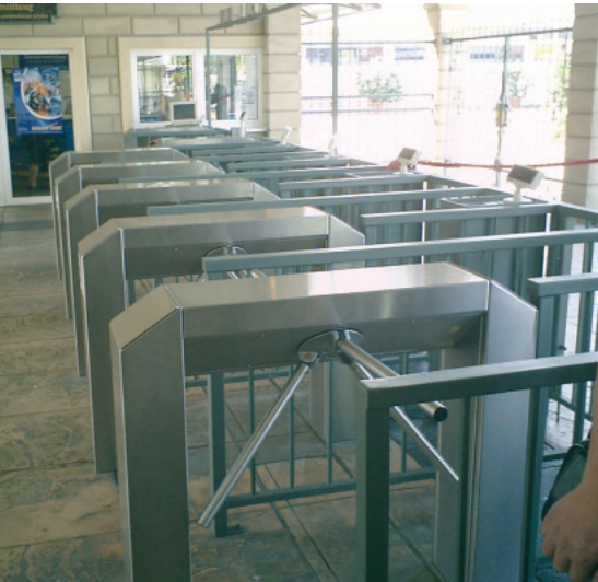
Bild 2: Zutrittskontrolle mittels Drehsperren
