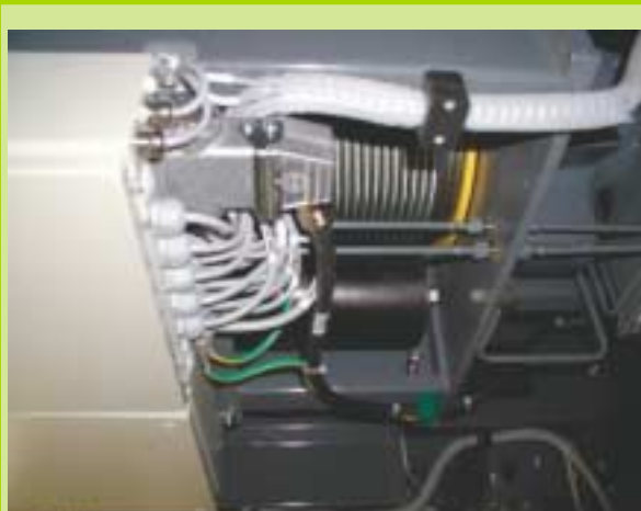
Antriebseinheit der Punktzugwinden, im Bild die Rückseite des Schaltschranks mit den Steckanschlüssen, oben ein Rechteckstecker des MC-Systems mit unbeschichtetem Gehäuse
