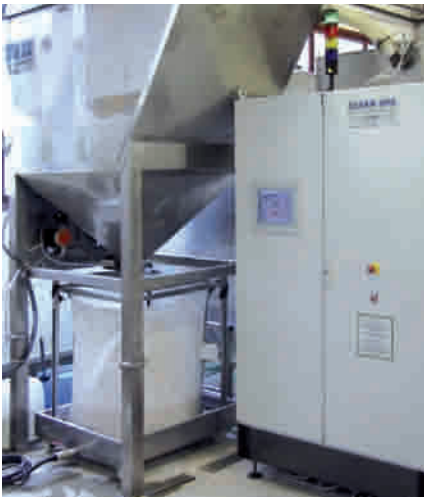
Die Wasserreinigungsanlage separiert den Schleifschlamm vom Wasser mit einer Geschwindigkeit von 800 l/min im Vollstrom.
