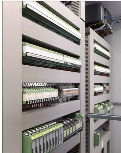
Bild 4: Koppelrelais und Analogwandler von Phoenix Contact sorgen für einen zuverlässigen Krankenhausbetrieb.
